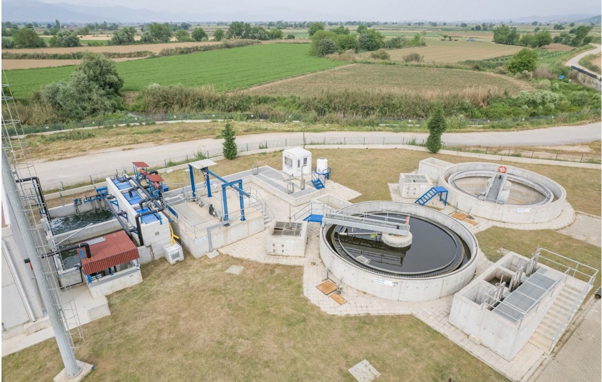
Bayındır Atık Su Arıtma Tesis Çıkış Suyu Arıtma Tesis
