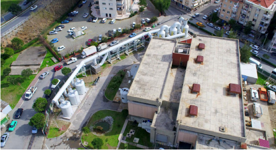
Merkez Atık Su Pompa İstasyonu
