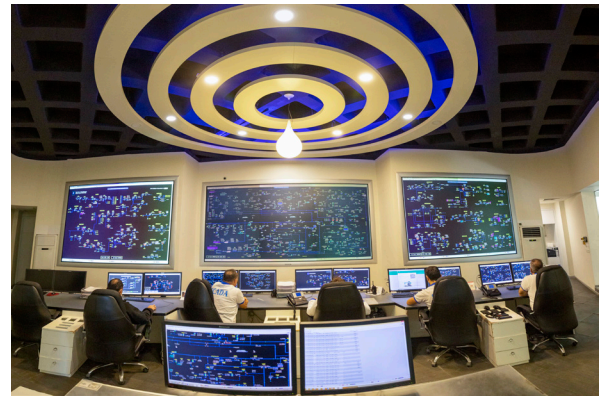
İZSU SCADA Sistemi
