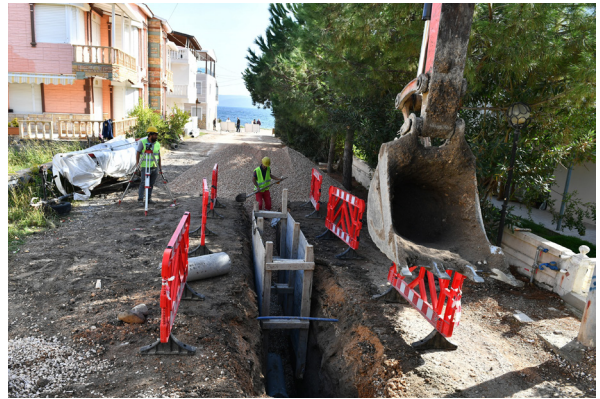
Bina ve Tekli Izgara Bağlantı Hattı İşİ
