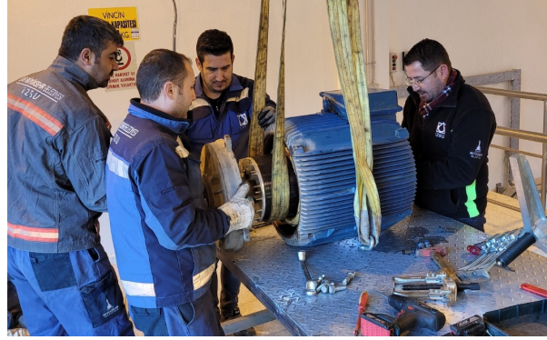
Kavaklıdere İSAT Durultucu Bakımı
