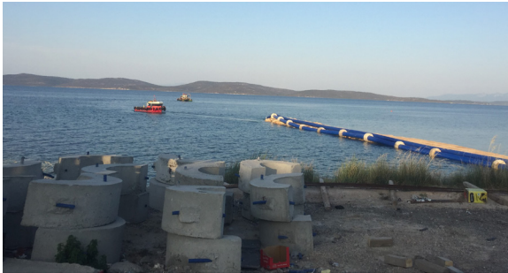
Karaburun Mordoğan Atık Su Arıtma Tesis Deniz Deşarjı Hattı
