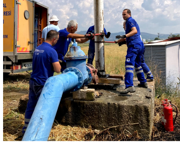
Göksu Pompa Bakım
