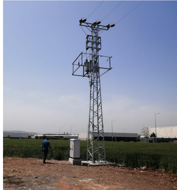
Torbalı İlçesi Çapak Mahallesi Sondaj Kuyusuna Enerji Temini
