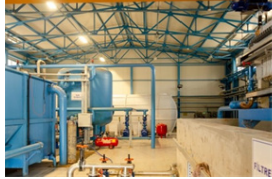
Bornova-Karaçam Göleti İçme Suyu Arıtma Tesisleri
