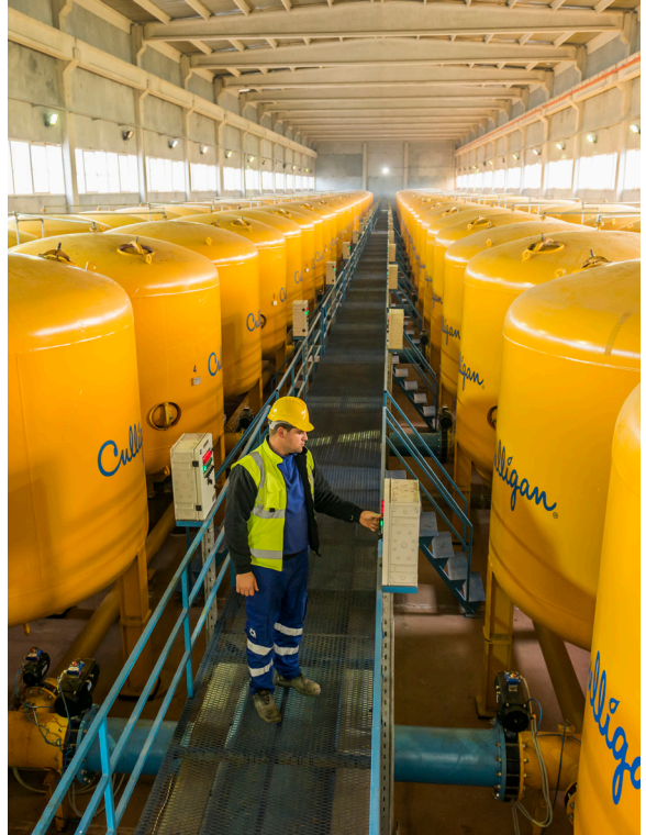
Çullu Arsenik Arıtma Tesisi Filtre Binası
