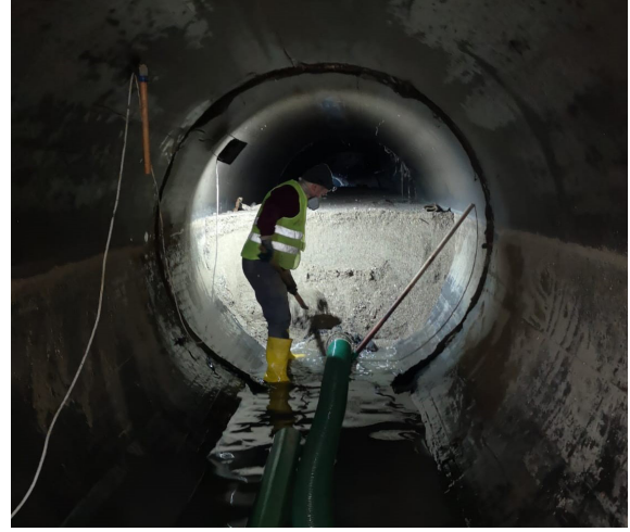
Galeri Mecra Hattının Bakım, Onarım ve Temizliği
