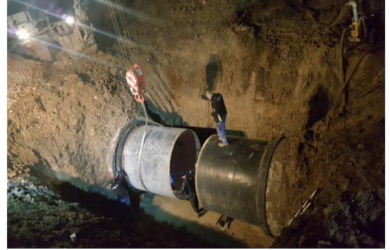
Çullu Arıtma Yahşelli Pompa Arası Ø2200 mm Boru Arızası Gece Çalışması
