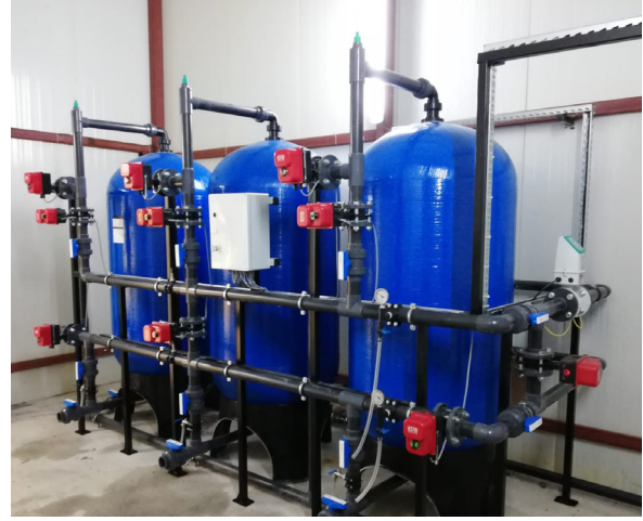
Kiraz Merkez Paket Arıtma Tesisi
