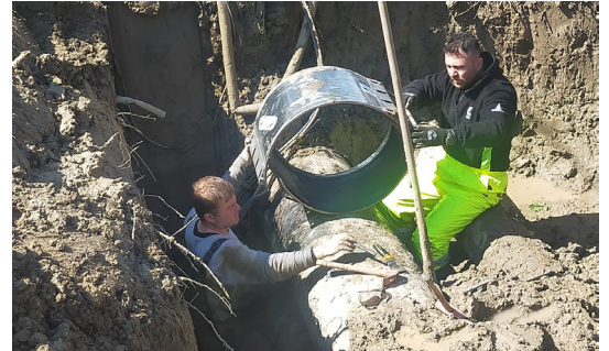
Çavuşköy kuyu hattı Ø600 mm Boru Arızası
