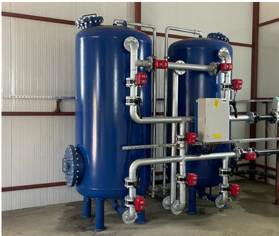
Köşeler Paket Arıtma Tesisi
